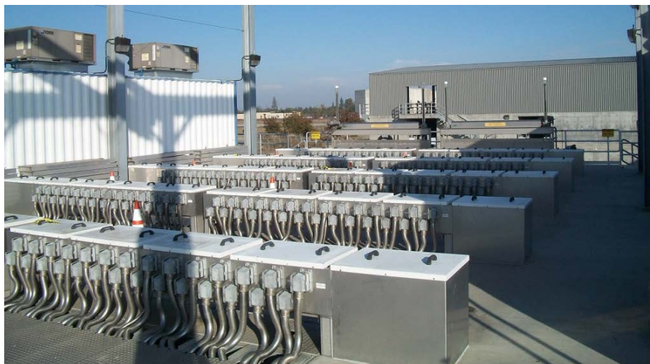
Figura 6. Sistema UV Manteca com dois canais paralelos de cinco bancos de lâmpadas cada.
